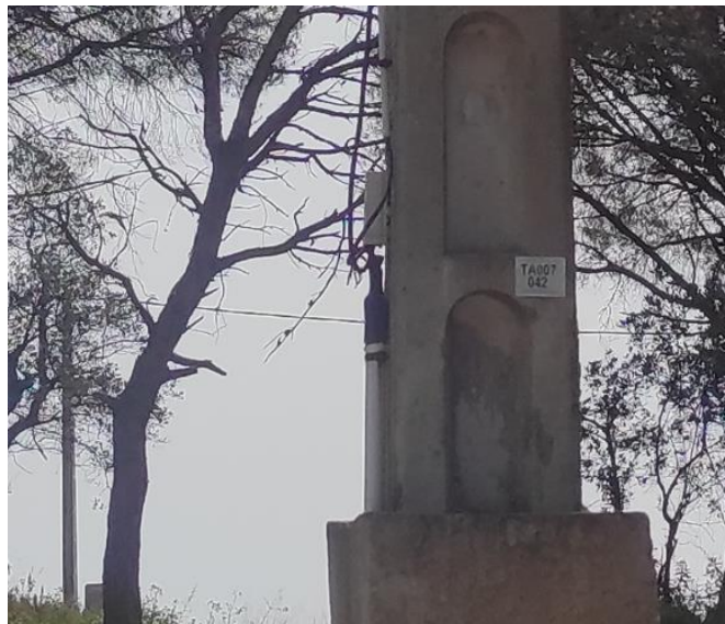
Imatge 2. Detall soterrament de línia d'enllumenat en pal de formigó
