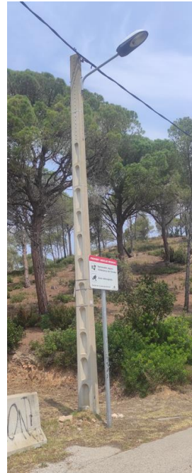
Imatge 1. Detall punt de llum penjat al pal de formigó de baixa tensió
