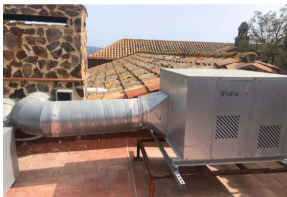
Conducto y motor de expulsión de humos de la cocina
