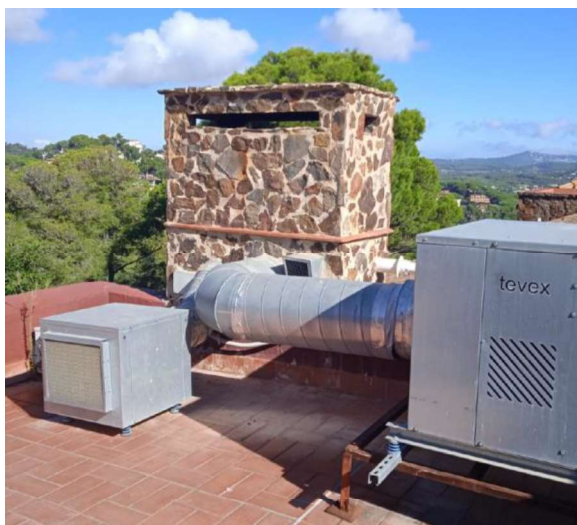
Conducto y motor de expulsión de humos de la cocina
