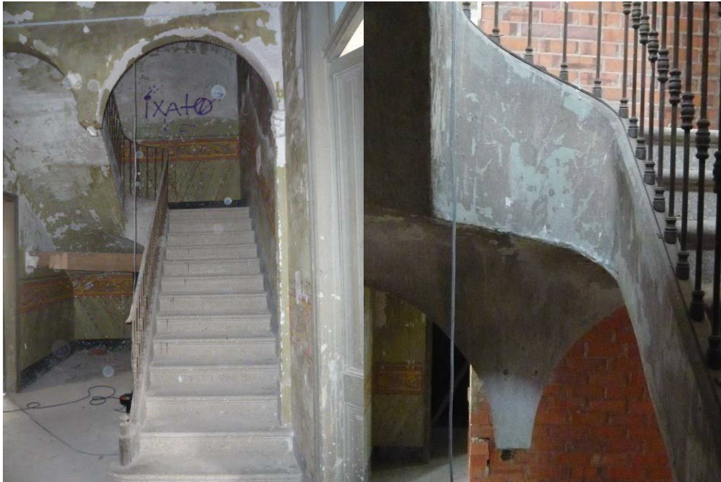
Arranque en planta baja
